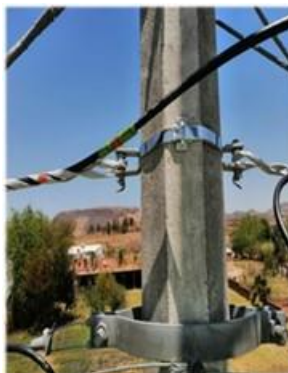
Herrajes en poste de concreto y metálico
