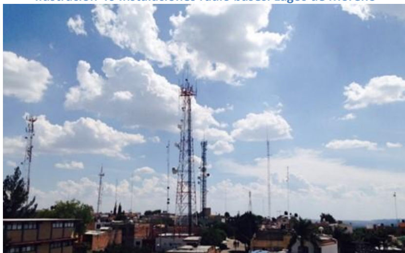
Ilustración 46 Instalaciones radio bases. Lagos de Moreno
